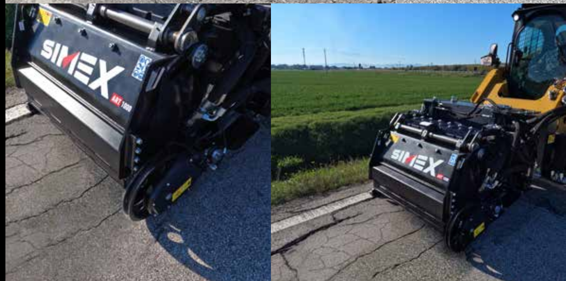
"Pelle di cocodrillo", fessurazioni, ammaloramenti.
